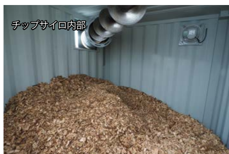
この例では、ボイラー室の20ft コンテナにチップサイロとして10ftのコンテナを連結しています。
