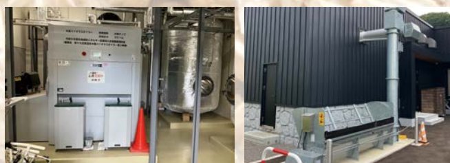
【型 式】 firematic 351×1台 【設置先】 吉岡温泉 様 【用 途】 温浴施設の給湯
