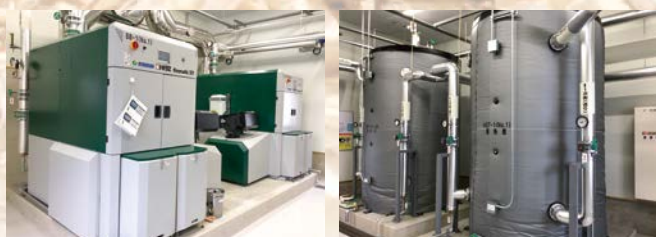
【型 式】 firematic 301×2台 【設置先】 厚岸町温水プール 様 【用 途】 温水プールの加温、シャワー、暖房
